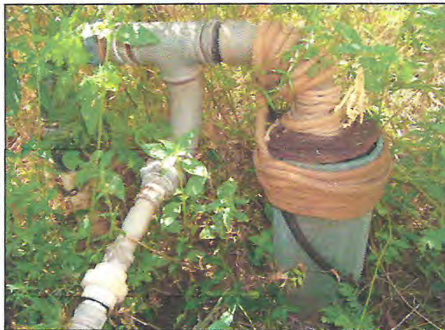
Foto 13: Poço tubular em PVC geo-mecânico (P57) - EMBRAPA/EPACE. (Coord.: 9193300/470136). Junho/2012.
