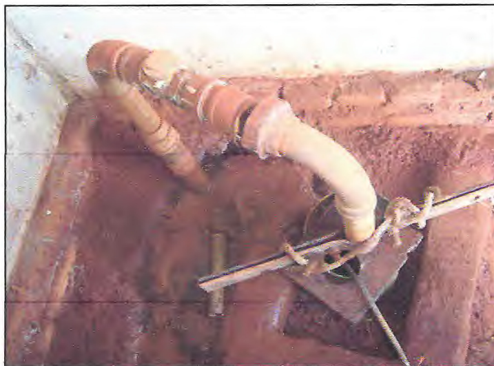
Fotos 15: Observa-se um poço sem qualquer proteção sanitária (P02) – Malhada Vermelha (Coord.: 9189754/468487). Junho/2012.
