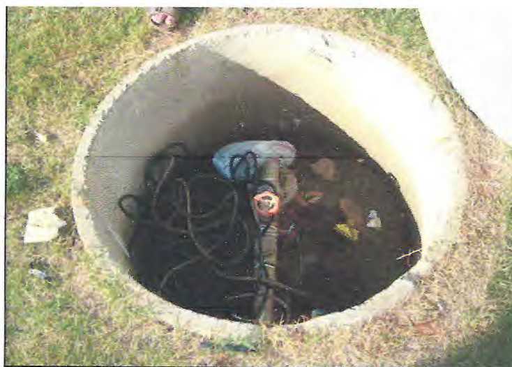
Fotos 16: Observa-se um poço apresentando cuidados quanto à proteção (P63) – CEASA (Coord.: 9193816/464877). Junho/2012.
