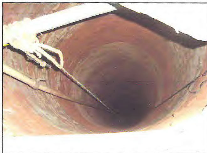
Foto 14: Poço manual, com revestimento de alvenaria, para uso doméstico e recreativo (P73) - AABB. (Coord.: 9193718/465825). Junho/2012.
