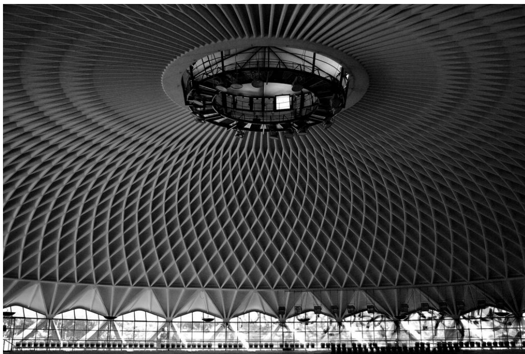
Fig. 22: Palazzetto dello Sport, concluído em 1959 - Roma. Características marcantes são a pouca espessura da casca de argamassa armada e o enorme vão vencido.
