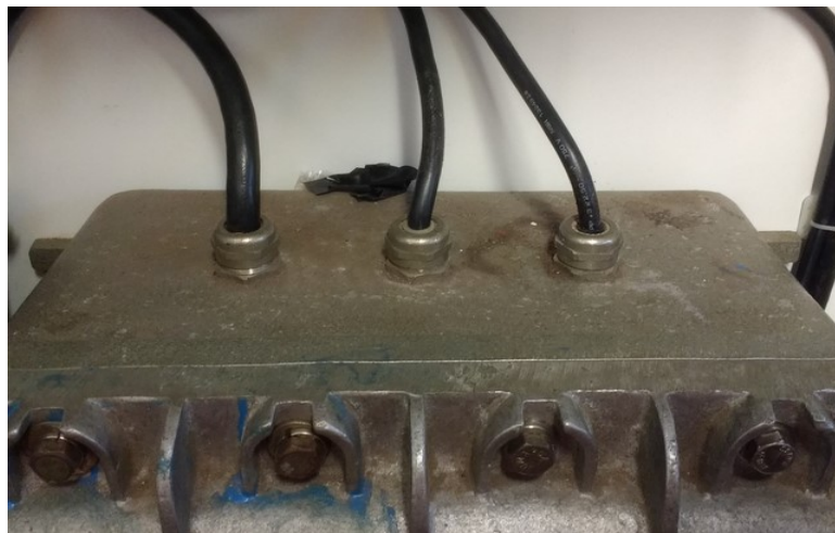
Figura 29 – Terminais tipo prensa cabo na parte superior de painel elétrico.
