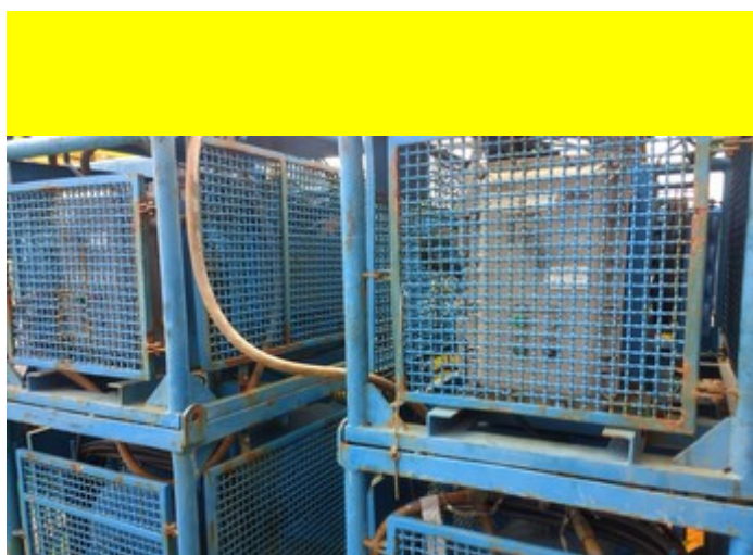
Figura 22 – Compressores protegidos com tela.
