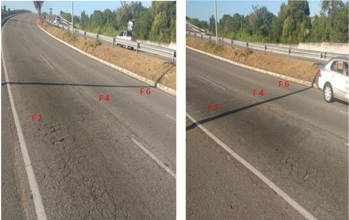
Figura 42 – Trincas couro de jacaré (Sentido 2)
