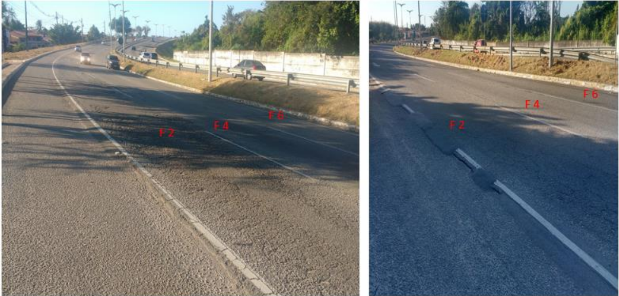
Figura 44 – Remendos e trincas (Sentido2)
