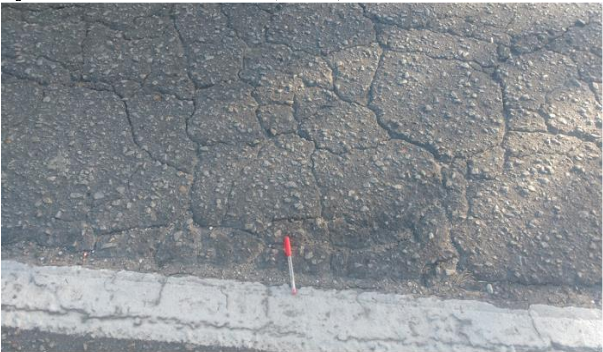
Figura 41 – Trinca com erosão nas bordas (Sentido 1)
