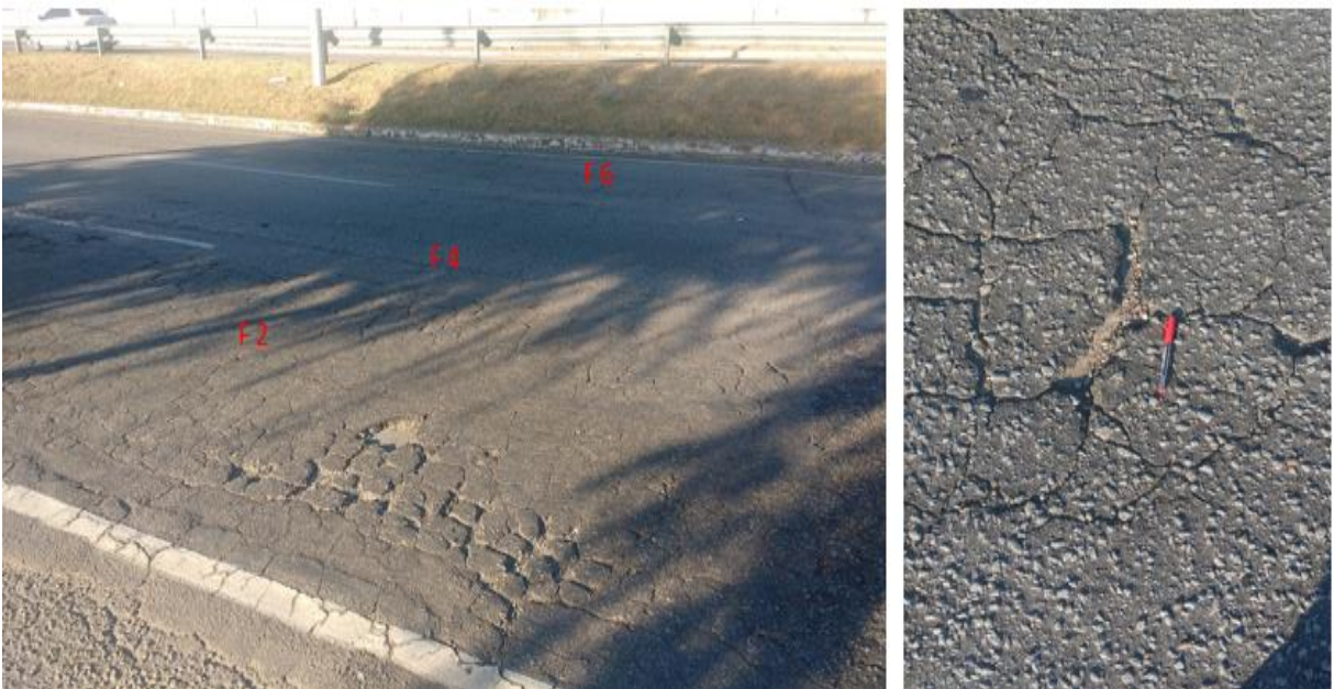
Figura 43 – Trinca com erosão nas bordas (Sentido 2)
