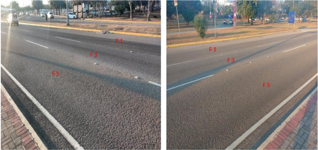
Figura 31 – Diferença na textura entre as faixas de tráfego (Sentido 1)
