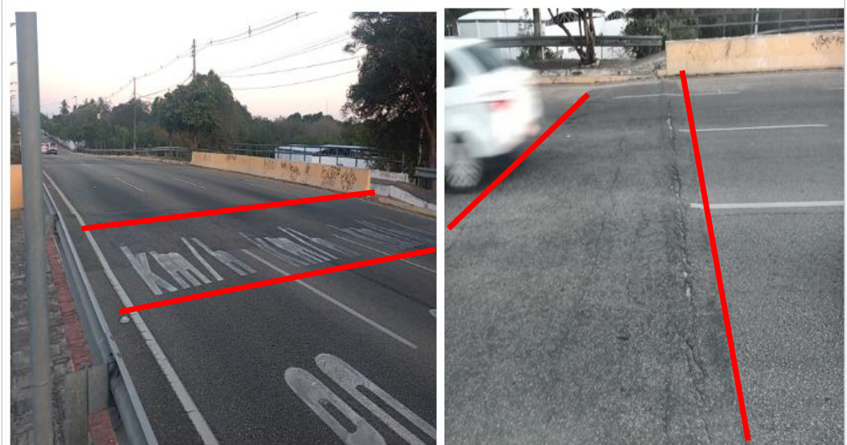
Figura 26 – Degrau na cabeceira do primeiro viaduto (Sentido 2)
