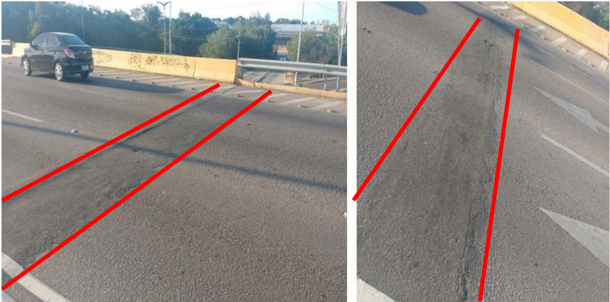
Figura 27 – Degrau na interseção do pavimento com o segundo viaduto (Sentido 1)
