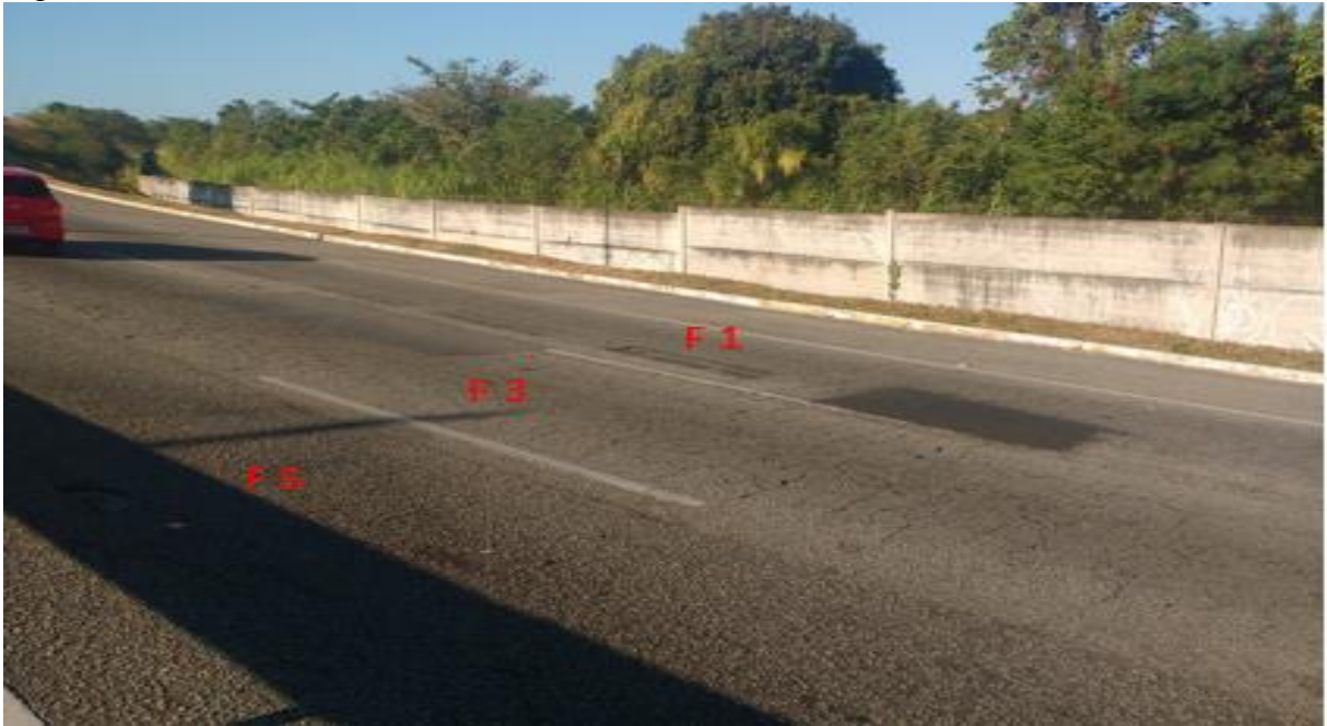
Figura 38 – Remendos e trincas transversais (Sentido 1)
