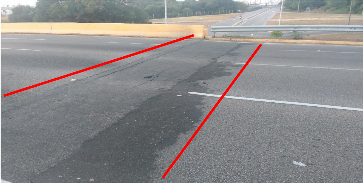
Figura 25 – Degrau na interseção do pavimento com o primeiro viaduto (Sentido 1)
