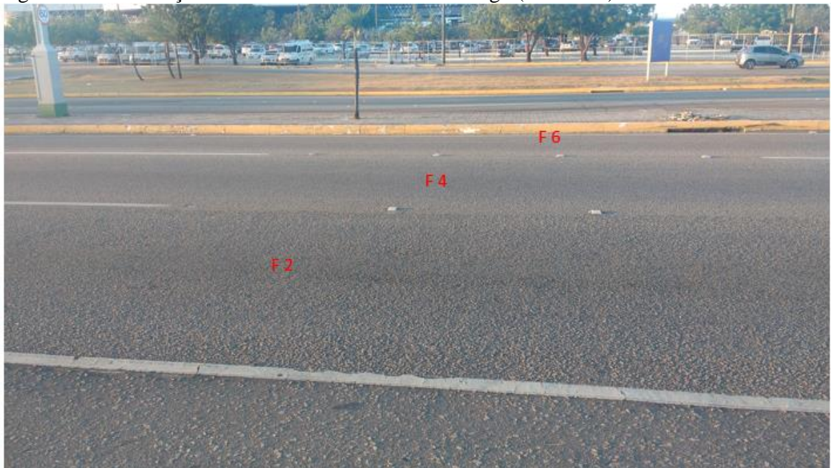
Figura 32 – Diferença na textura entre as faixas de tráfego (Sentido 2)
