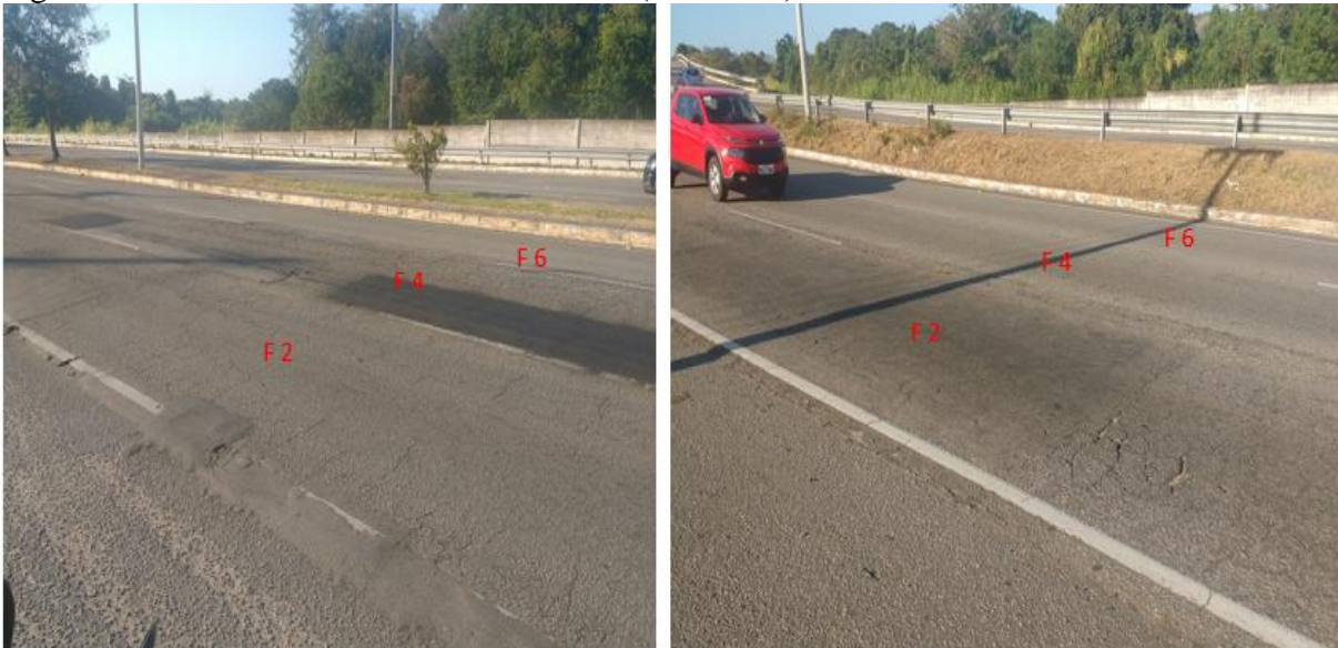
Figura 45 – Remendos e trincas transversais (Sentido 2)
