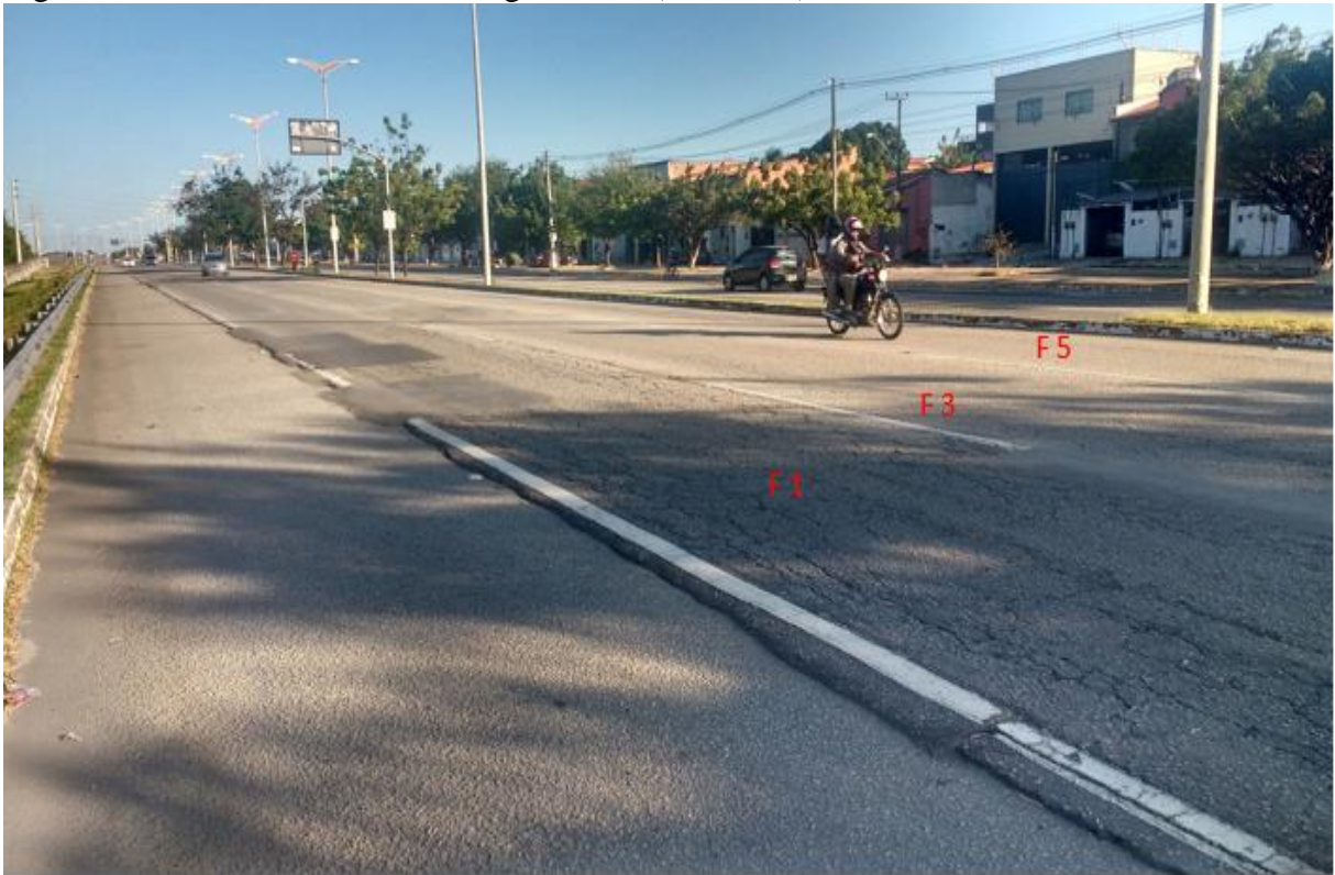
Figura 40 – Remendos e trincas longitudinais (Sentido 1)
