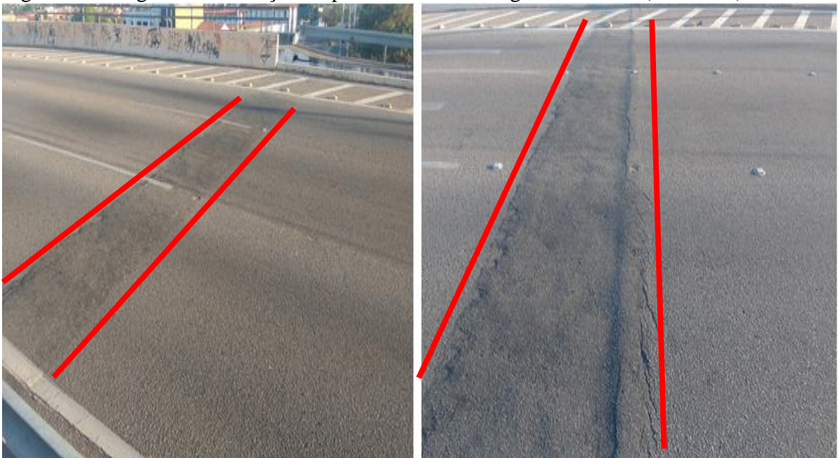
Figura 28 – Degrau na interseção do pavimento com o segundo viaduto (Sentido 2)
