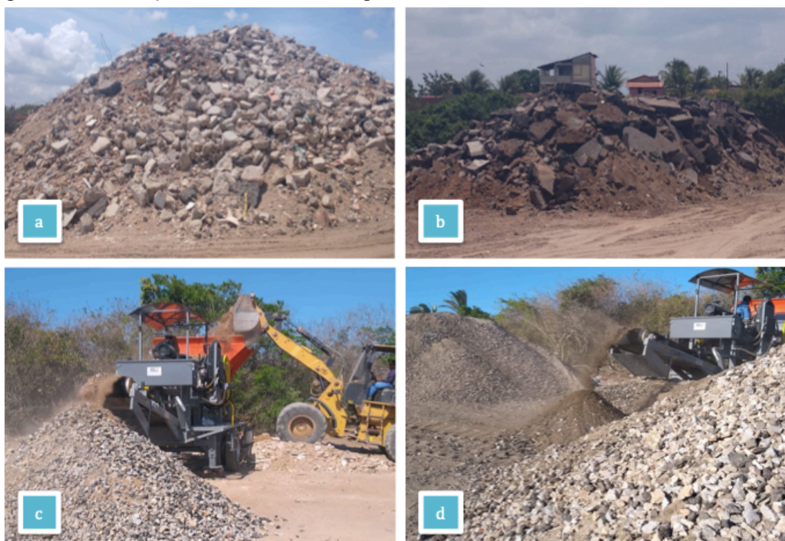
Figura 12 – Instalações da usina de reciclagem B
