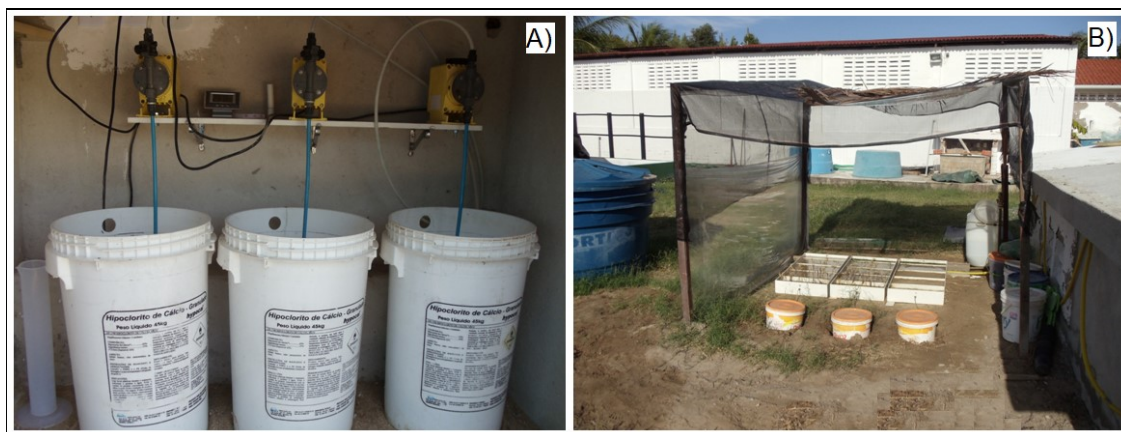
Figura 10 – Bombas dosadoras, mangueiras pneumáticas azuis e recipientes com água/efluente (A). Cobertura dos sistemas com sombrite (B).
