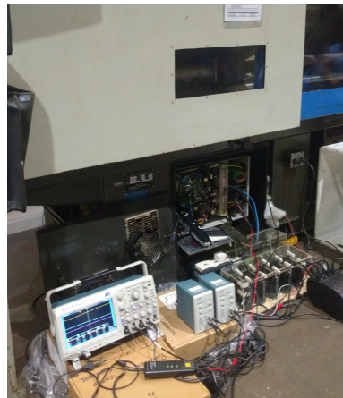
Figura 6.7 – Equipamentos de medição conectados a Injetora GEK.
