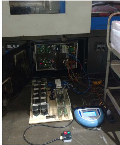
Figura 6.12 – Analisador de energia conectado a Injetora GEK.
