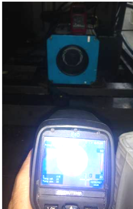
Figura 3.8 – Procedimento experimental: análise termográfica em um PMSM de 23 kW.
