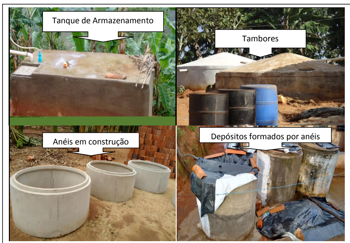
Figura 30 - Equipamentos de Armazenamento de Água.
