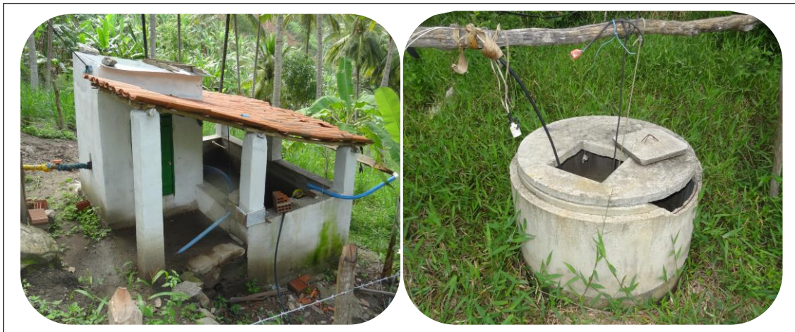
Figura 12 - Sistema de bombeamento de água para as casas.
