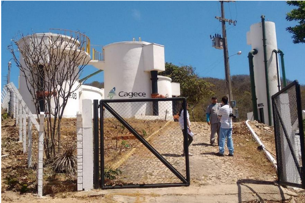
Figura 5 - Estação de Tratamento de Água (ETA) do SAA Pecém.
