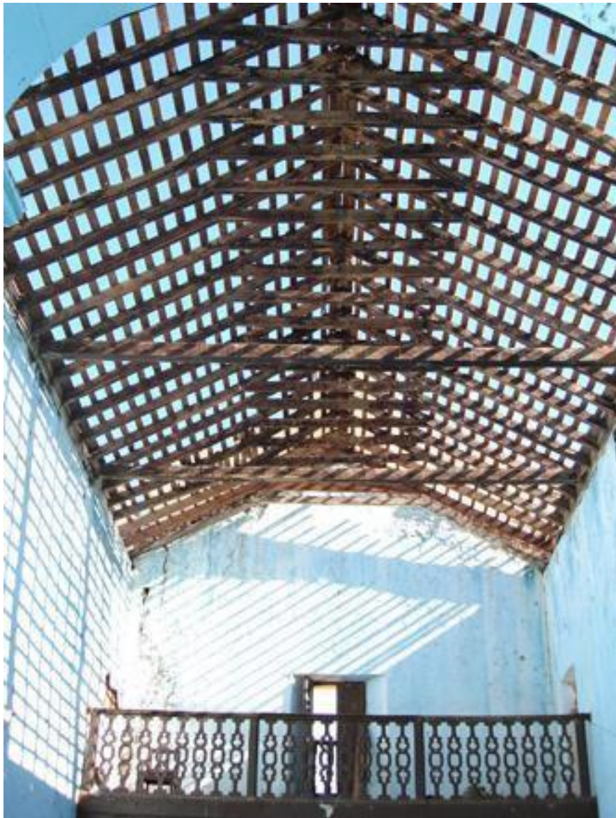
Figura 364 – Coberta em caibro-armado da capela de São Caetano, em Naranjú, Várzea Alegre-CE
