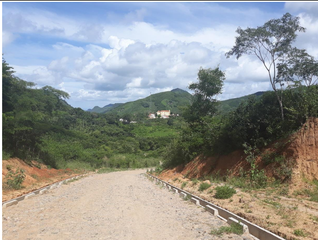
Figura 251 – Vista de Santa Cruz a partir da estrada vicinal que lhe dá acesso.
