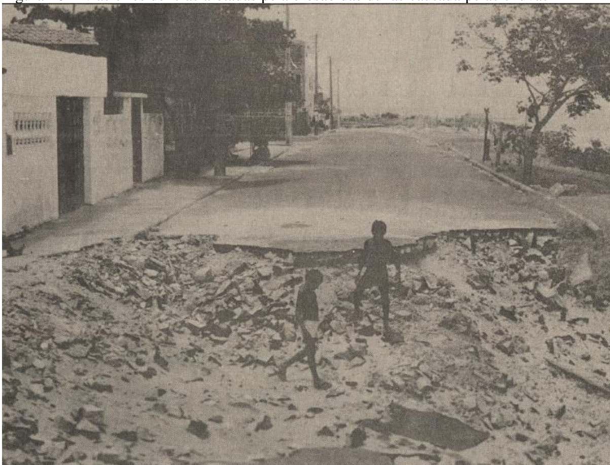
Figura 20 – Vias e residências afetadas pela erosão das dunas causada pelas chuvas
