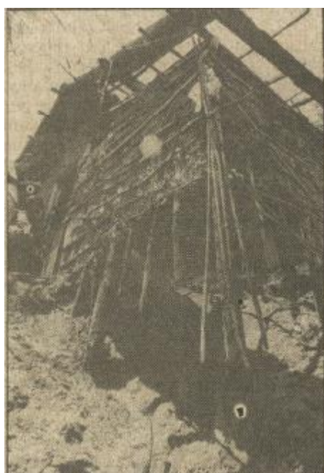
Figura 22 – Barraco em perigo de desabamento no Morro Santa Terezinha em 1988
