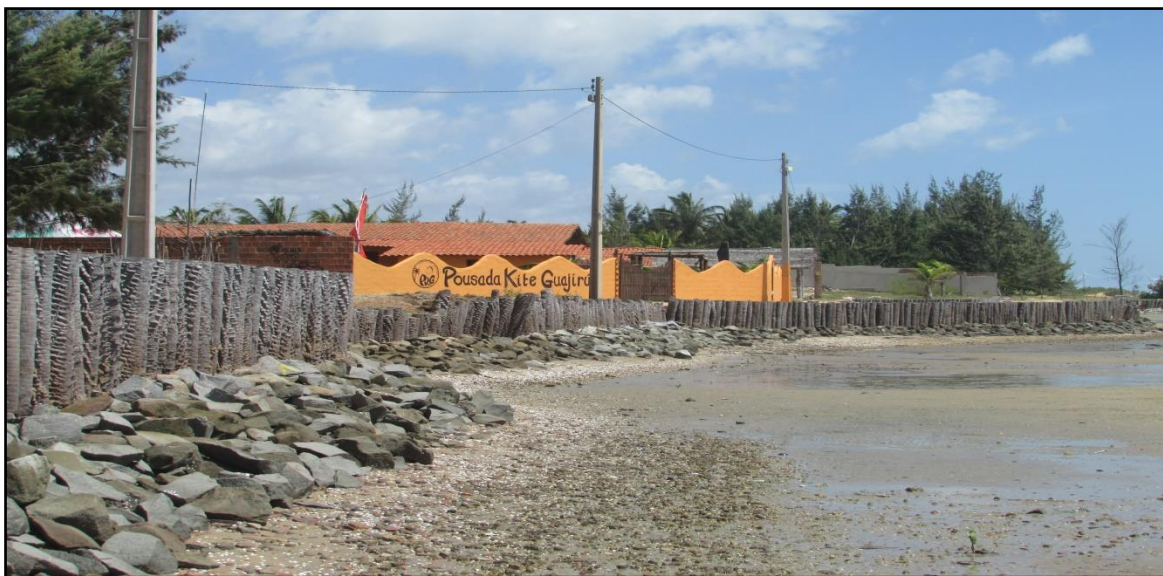
Figura 62– Estruturas rígidas para contenção da erosão na área abrigada da linha de costa
