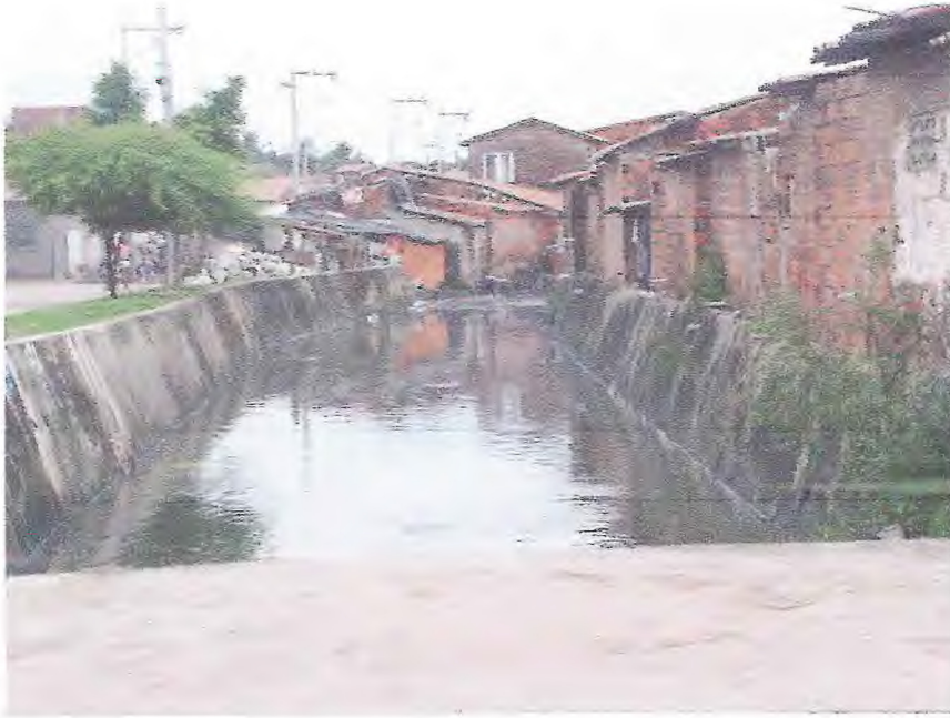
FIGURA 8 – Canal de Abastecimento Açude Santo Anastácio, Fortaleza – Ceará, com água proveniente da Lagoa de Parangaba, Fortaleza – Ceará.
