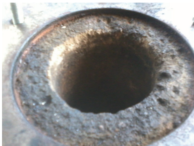
Figura 25: Isolamento refratário de caldeira 12,5 mm de espessura
