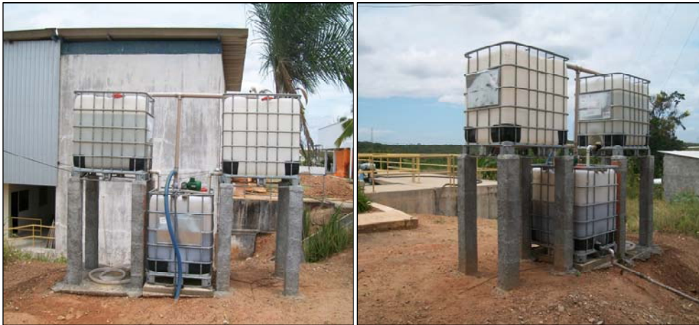
Figura 12- Contêineres de armazenamento da Água de Lavagem do Filtro 16.
