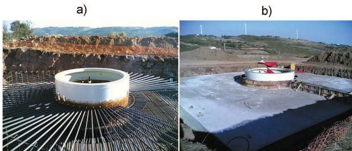
Figura 4 – Fundação de uma turbina eólica antes (a) e depois (b) da betonagem no parque eólico de Fontelas (Portugal).
