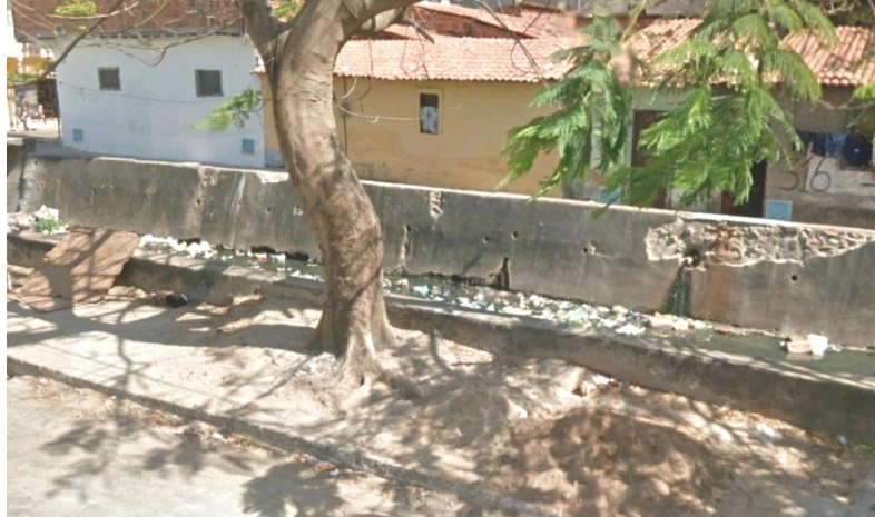
Figura 24 – Despejo de Esgoto 2
