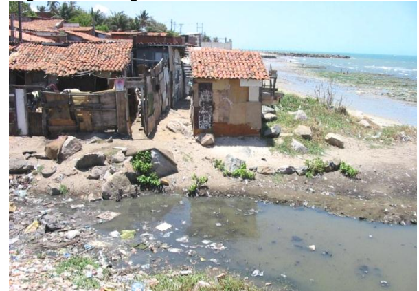
Figura 33 – Esgoto a céu aberto.
