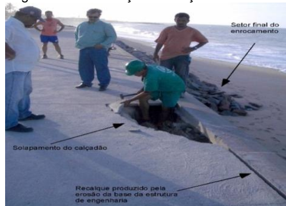
Figura 25 – Destruição do calçamento.
