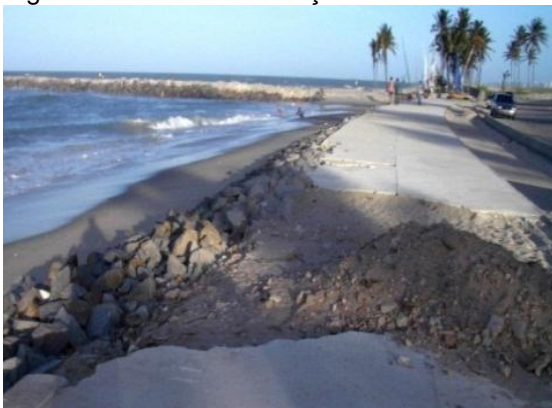
Figura 24 – Erosão do calçamento.
