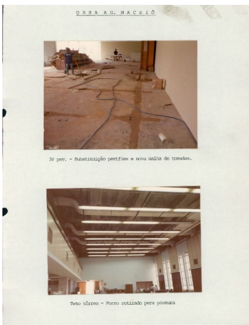
Edifício de Maceió-AL: fragmento de um relatório de reforma realizado em 1987.
