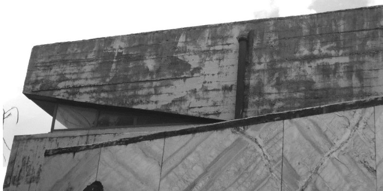
Figura 3.77 – Edifício de João Pessoa: detalhe da viga.
