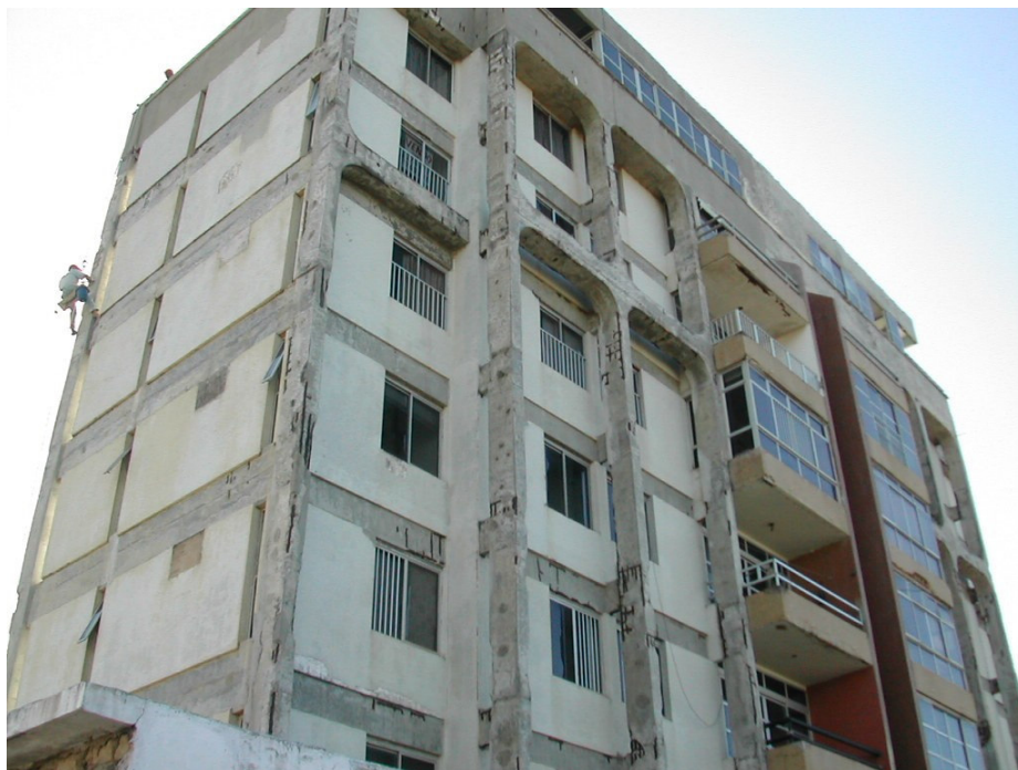
Figura 2.6 – Corrosão em armaduras de edifício em estado avançado.
