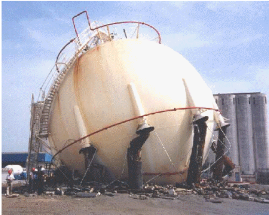
Figura 2.4 – Esfera de GLP com capacidade de 2000 m 3 : O acidente ocorreu devido a uma severa corrosão nas pernas.
