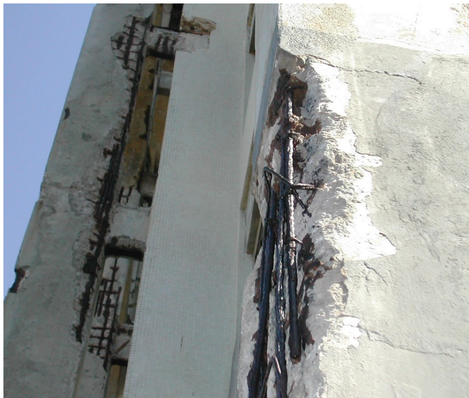
Figura 2.18 - Corrosão em estado avançado em armaduras de colunas de edifício.
