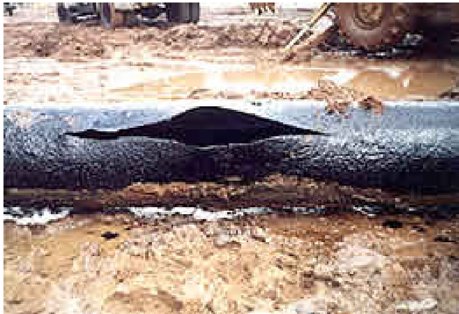
Figura 2.5 – Oleoduto rompido por corrosão.
