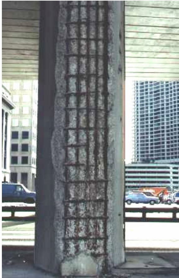
Figura 2. 16 – Pilar de viaduto: a corrosão nas armaduras em estado avançado.
