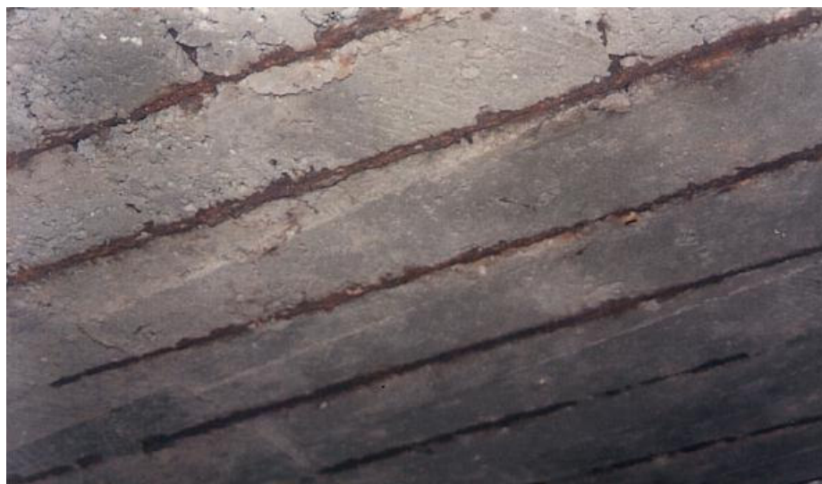
Figura 2.17 - Corrosão das armaduras em lajes de concreto armado.
