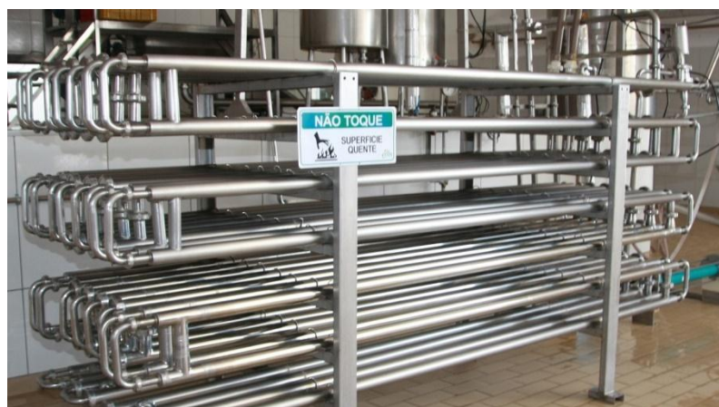
FIGURA 5 – Pasteurizador horizontal tubular.
