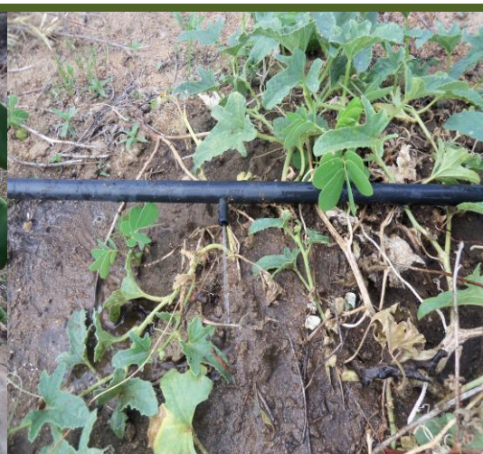
Figura 34 - Detalhe do Sistema de gotejamento.
