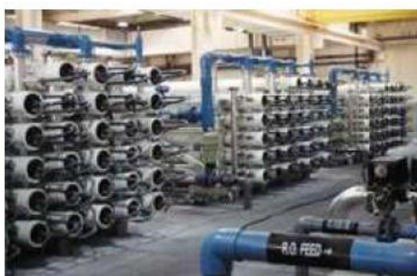
Figura 7 – Planta de nanofiltração para dessulfatação da água do mar.
