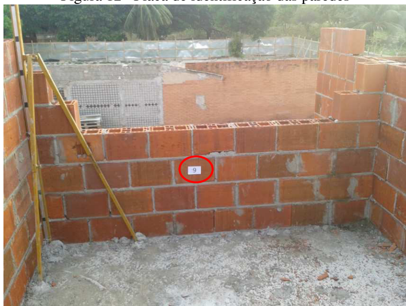
Figura 12– Placa de identificação das paredes
