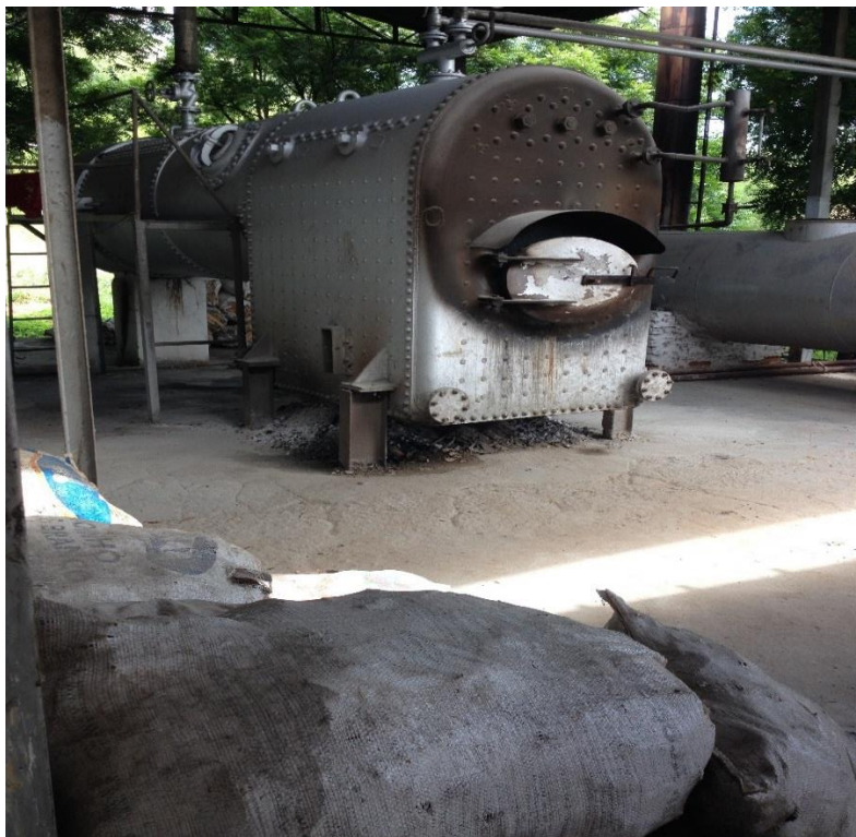
Figura 8 – Caldeira para aquecimento da peletizadora
