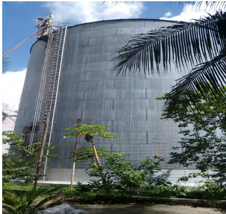
Figura 11 – Silo de alumínio para estocagem de ingredientes da Fábrica III
