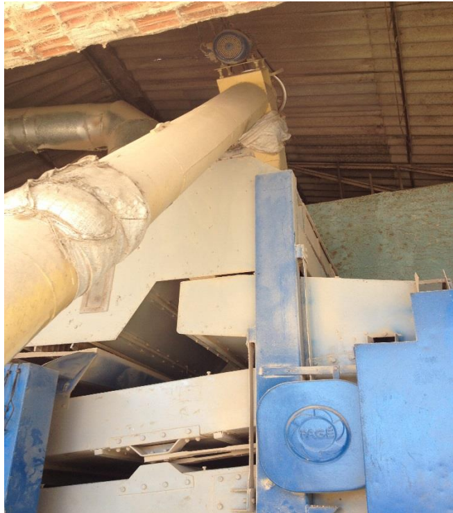
Figura 22 – Máquina de pré-limpeza da Fábrica I
