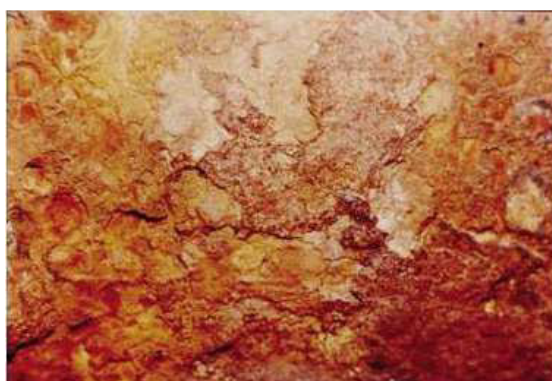
Figura 2 – Corrosão generalizada em chapa de aço-carbono.
