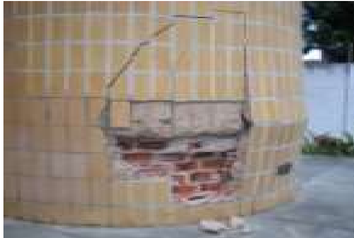
Figura 19 - ruptura de revestimento por deformação estrutural.
