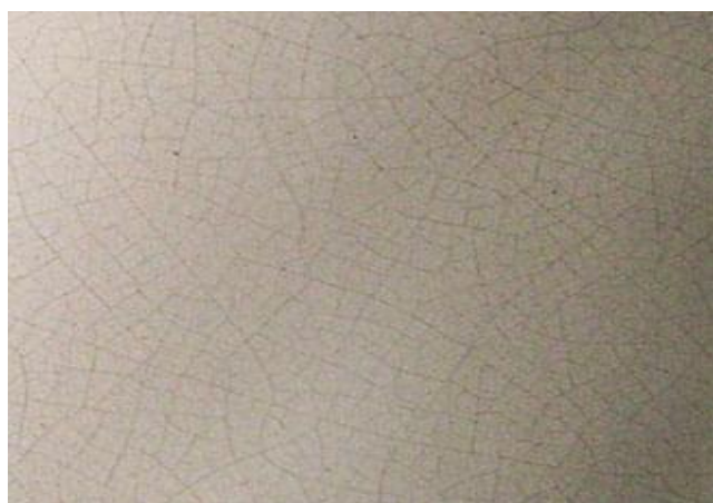
Figura 22 - aspecto do gretamento em placa cerâmica
