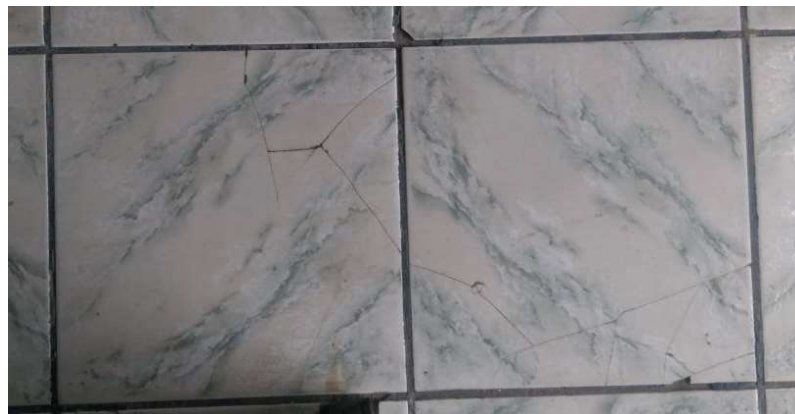
Figura 20 - trincas em revestimento cerâmico.
