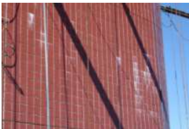
Figura 23 - eflorescência em revestimento cerâmico
