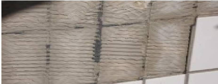
Figura 16 - descolamento entre placa cerâmica e argamassa de assentamento
