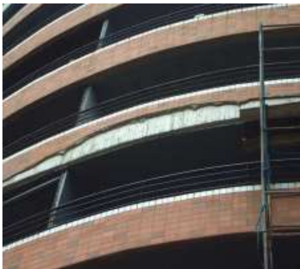
Figura 18 - descolamento entre emboço e substrato
