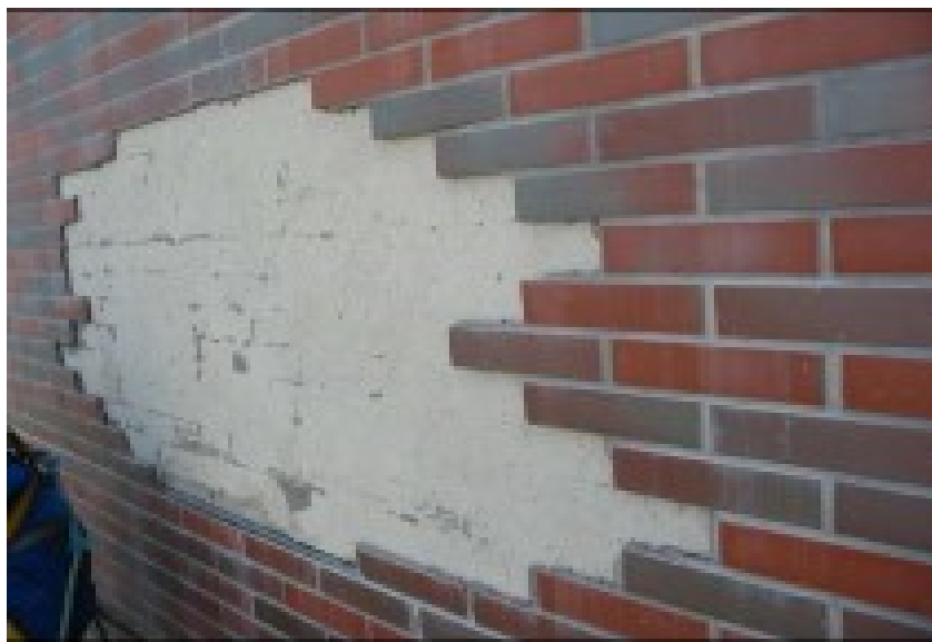
Figura 17 - descolamento entre argamassa de assentamento e emboço
