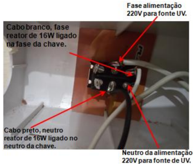
Figura 6 – Detalhe da chave de segurança da lâmpada de UV, que interliga o reator de 16W ao cabo da alimentação de 220V.
