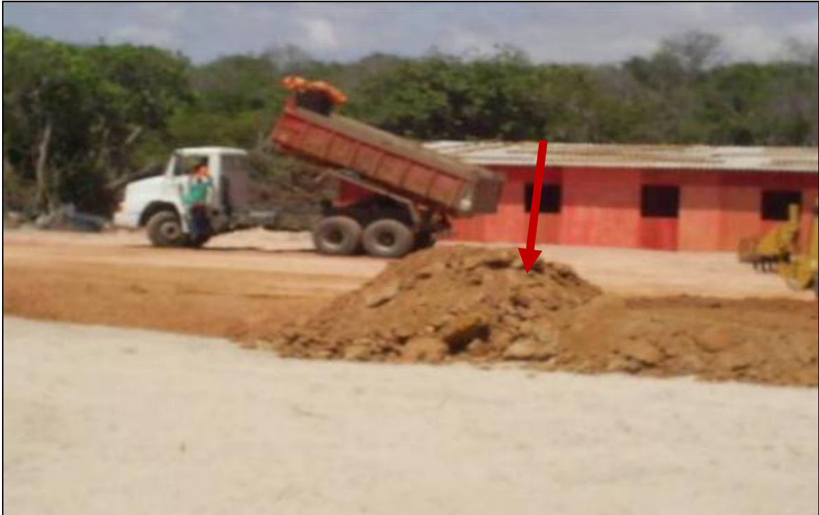
Figura 16 - Material areno-argiloso introduzido no campo de dunas e sobre a via de acesso aberta para o tráfego de veículos no campo de dunas da Taíba, Ceará.
