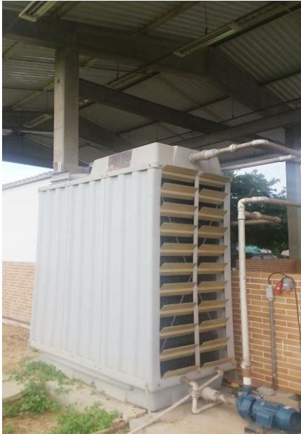
Figura 9 - Torre de resfriamento do sistema
