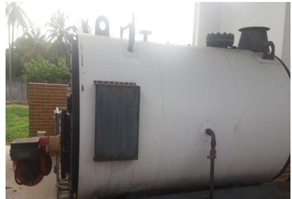
Figura 7 - Caldeira a gás
