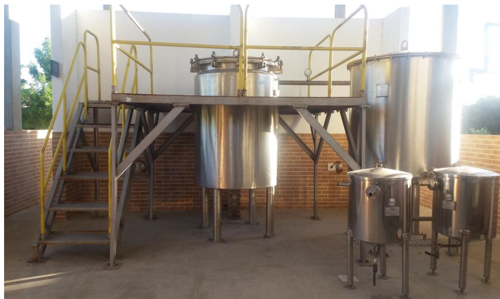
Figura 8 - Extrator à esquerda, condensador à direita, coletor à frente
