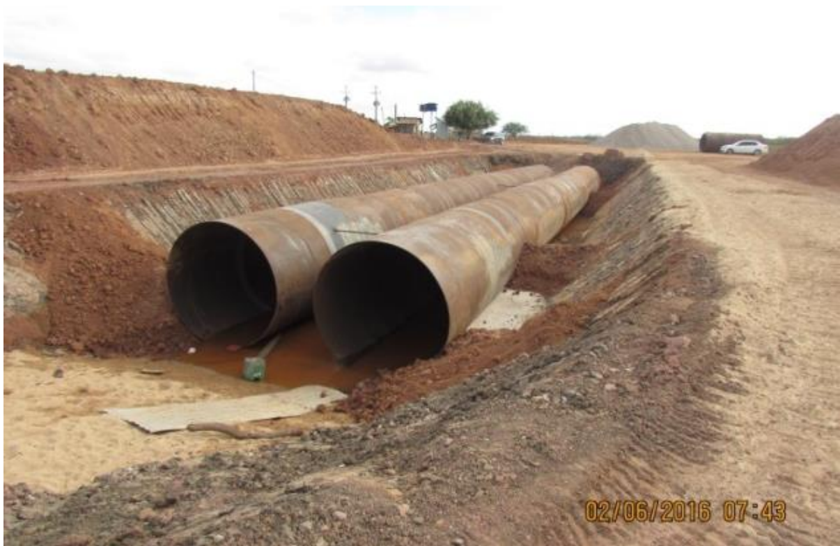
Figura 13 – Tubulação hidráulica que interliga os dois lados da lagoa de São Bento
