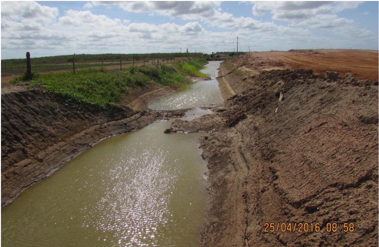
Figura 05 – Canal de transposição de águas do Rio Jaguaribe para o abastecimento das fazendas de fruticultura próximas em fase de construção
