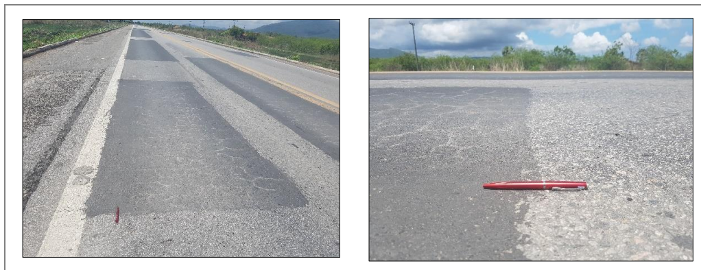
Figura 34 – Vista geral e detalhe dos remendos
