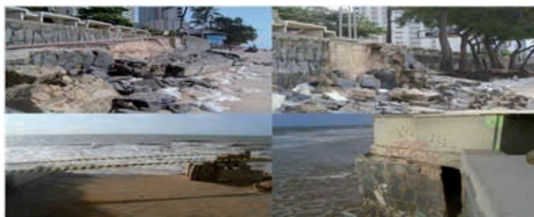
Figura 1 – Danos provocados pela erosão na praia de Boa Viagem, Recife/PE (Fonte: Góis, 2011)
