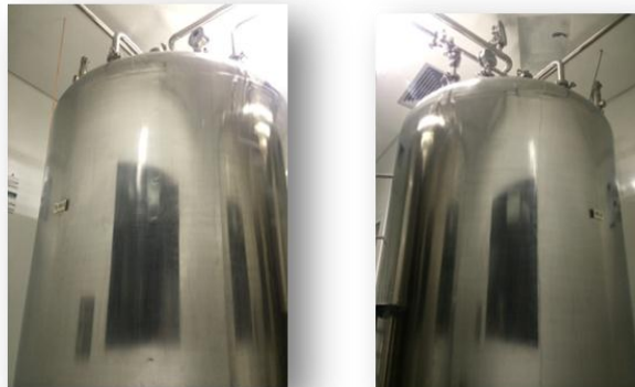
Figura 11 - Tanques de preparo
