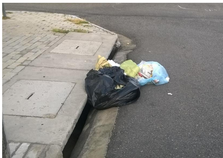
Figura 18 - Material acumulado em bocas de lobo
