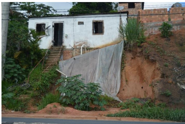
Figura 15 – Ocupação em área de grande declividade, 21/04/2015
