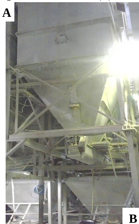
Figura 16 - Silo dosador (A) e Balança (B)
