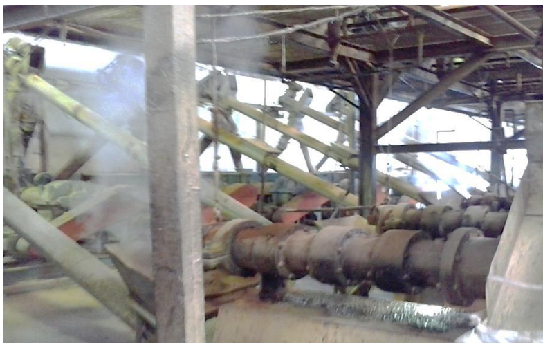
Figura 18 - Máquinas extrusoras ligadas às prensas.
