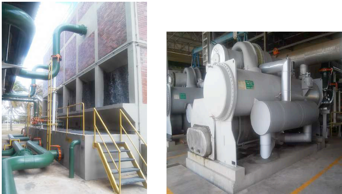
Figura 7 – Torre de Resfriamento e Chiller
