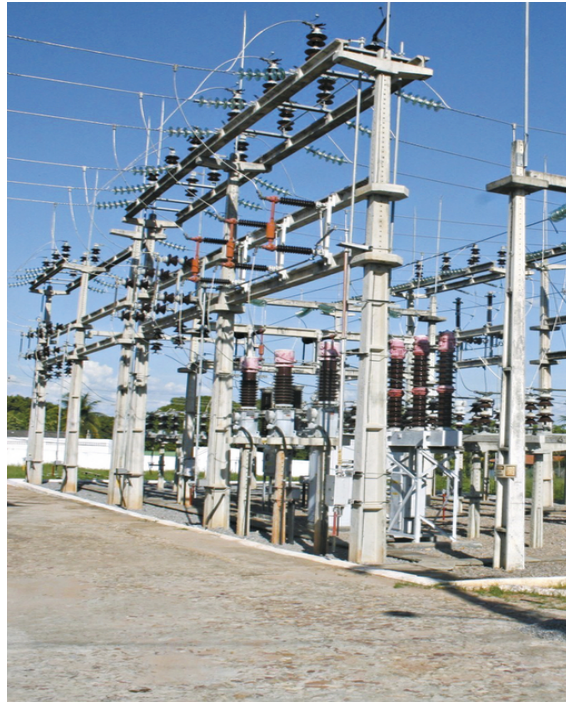
Figura 2.1 - Subestação Fortaleza II/Quixada
