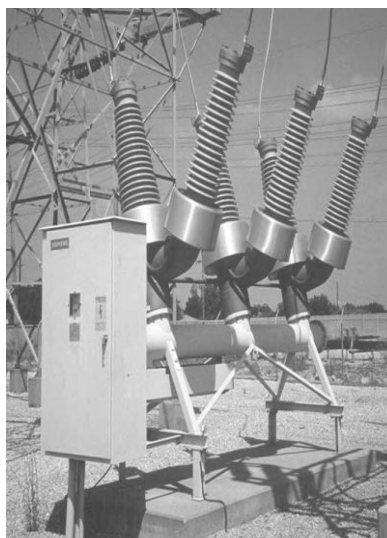
Figura 2.3 - Disjuntor a gás
