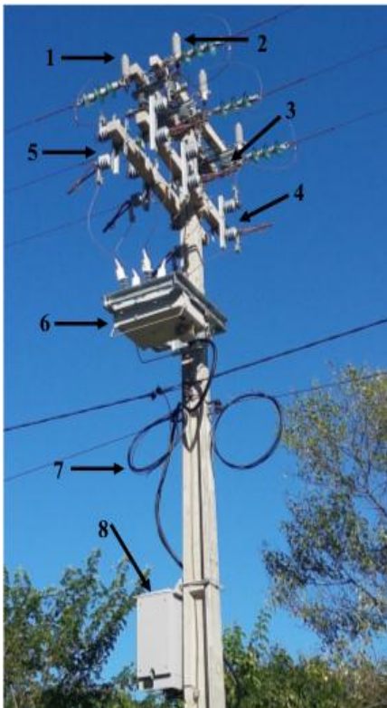
Figura 2.7 - Religador instalado na rede Pici
