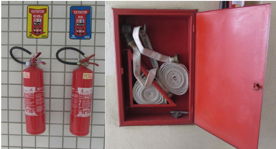
Figura 8 - Extintores de CO 2 , Pó químico do tipos “BC” e Hidrante
