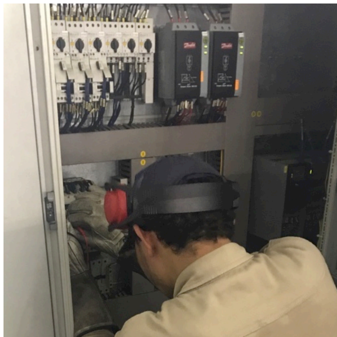
Figura 12: Medição das tensões elétricas no painel elétrico
