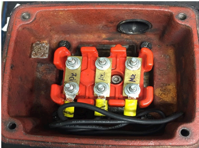
Figura 14: Caixa de ligação de um motor
