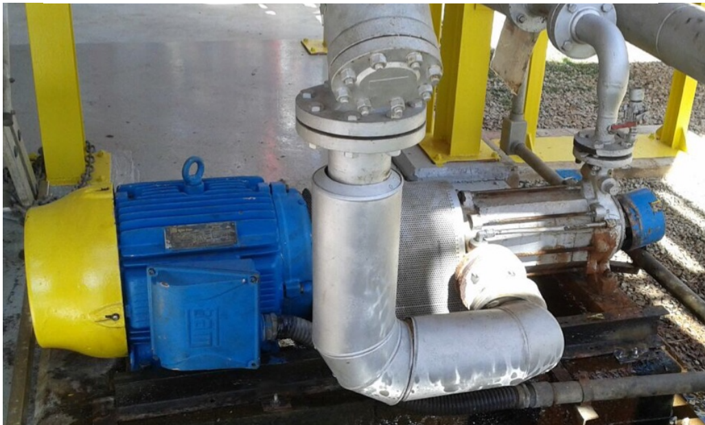
Figura 16: Motor da Caldeira
