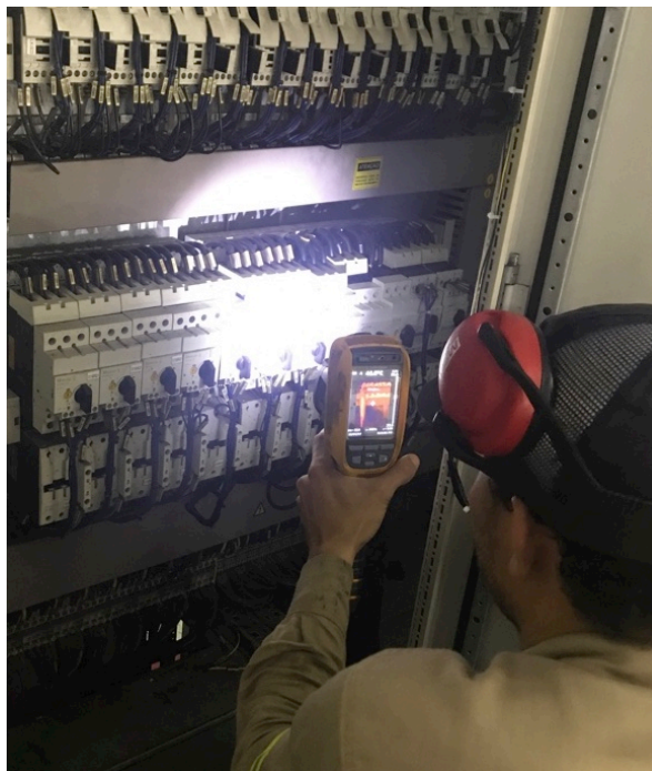
Figura 13: Medição termográfica no painel elétrico do motor
