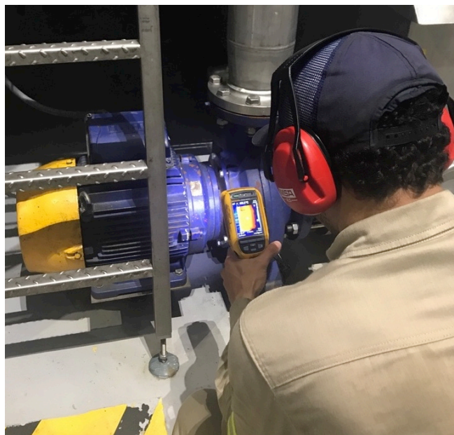
Figura 10: Medição termográfica em um motor
