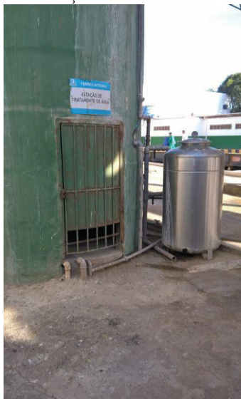
Figura 6 - Estação de tratamento da FINT 1.
