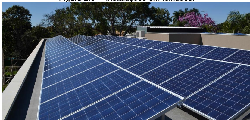
Figura 2.6 – Instalações em telhados.
