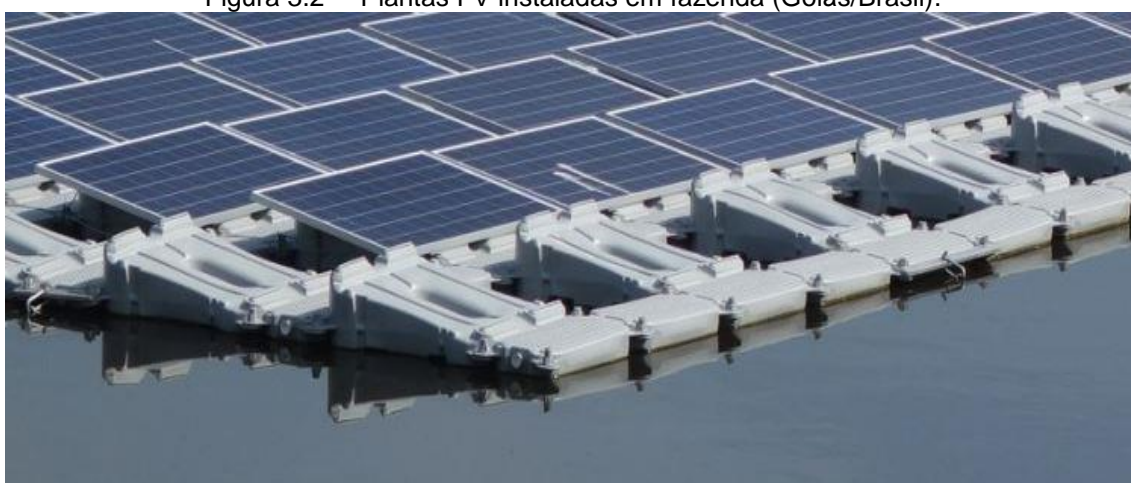
Figura 3.2 – Plantas FV instaladas em fazenda (Goiás/Brasil).
