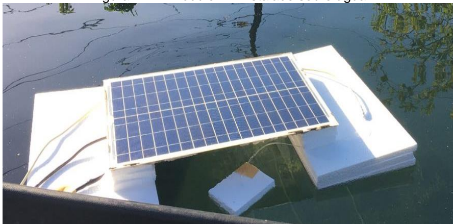
Figura 4.2 – Módulo FV instalado sobre água.
