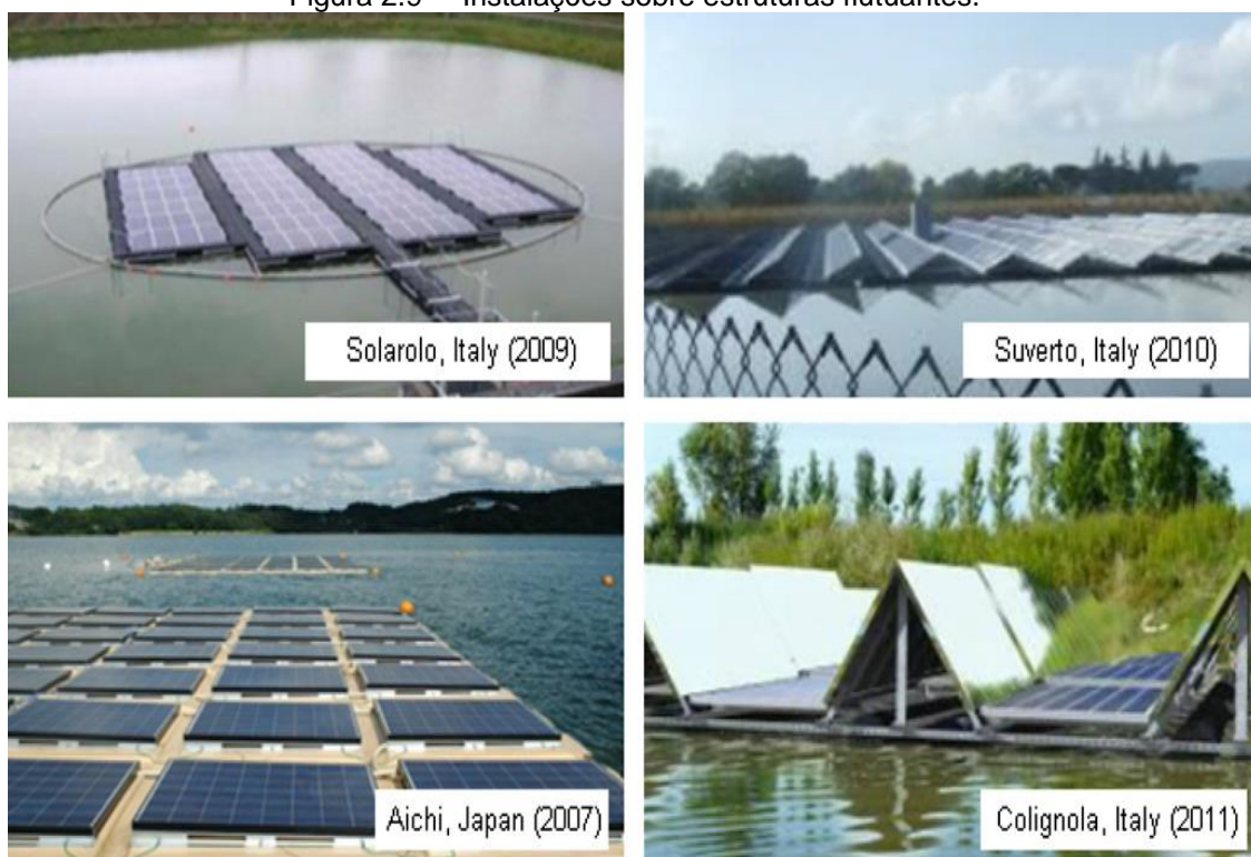
Figura 2.9 – Instalações sobre estruturas flutuantes.
