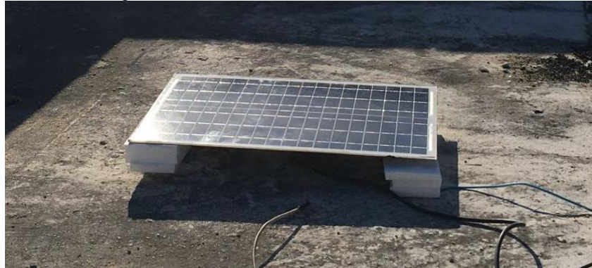
Figura 4.1 – Módulo FV instalado sobre o solo.
