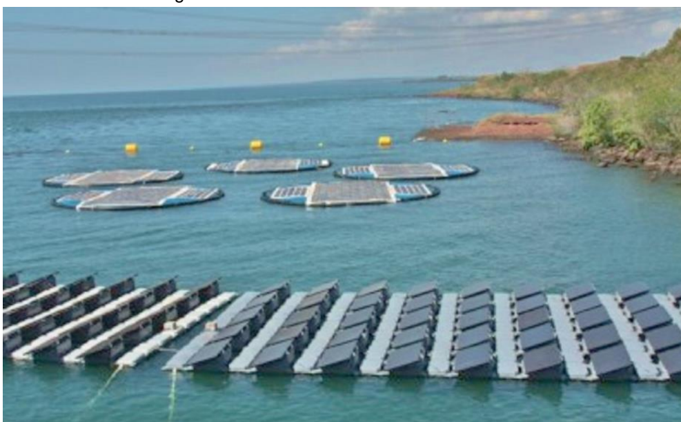
Figura 1.2 – Usina FV flutuante de Rosana - SP.
