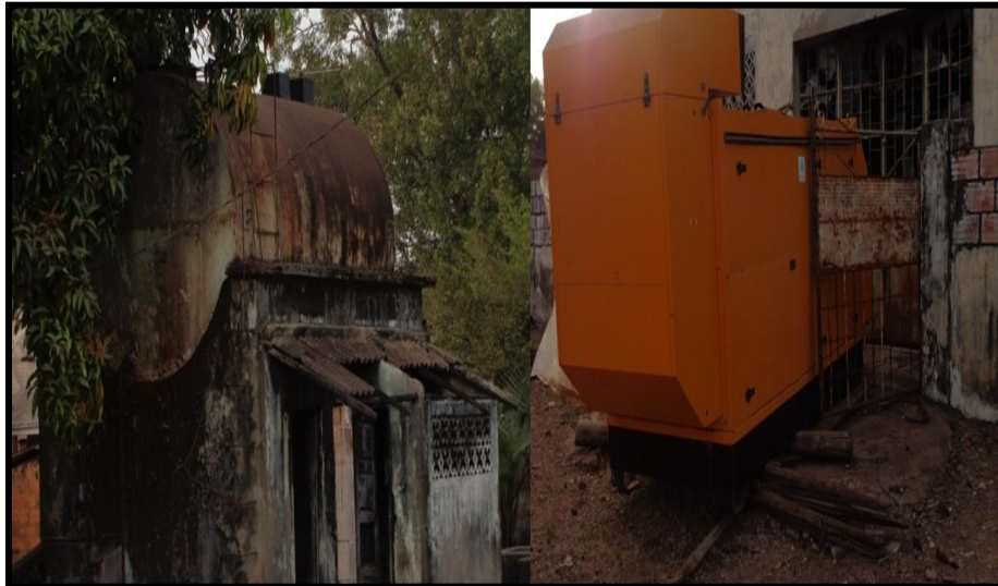
Figura 13- Geradores elétricos usados para geração de energia no município Cacheu.
