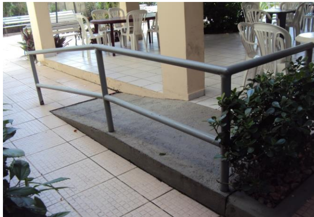
Figura 9 – Bloco Didático II – Rampa acessível sem sinalização visual. Fonte: Pesquisa de Campo.
