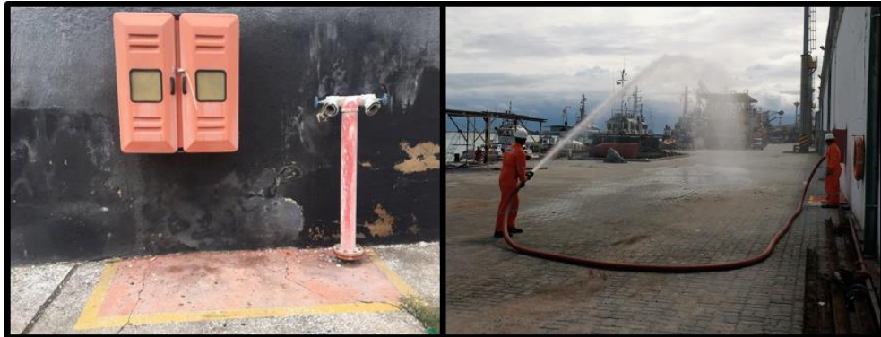
Figura 14 - Sistema de combate a incêndio do Cais Comercial
