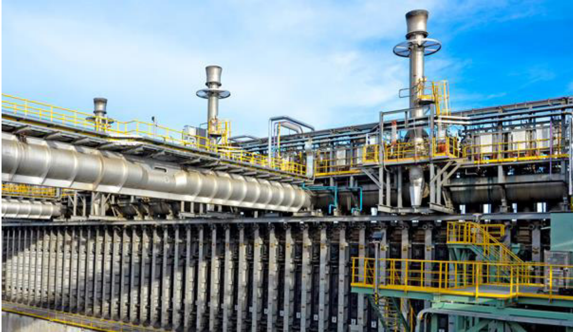
FIGURA 1: Visão geral de uma coqueria.
