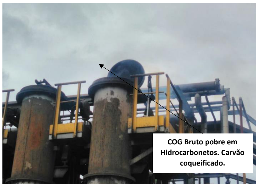
FIGURA 23: Inspeção visual de um forno coqueificado.
