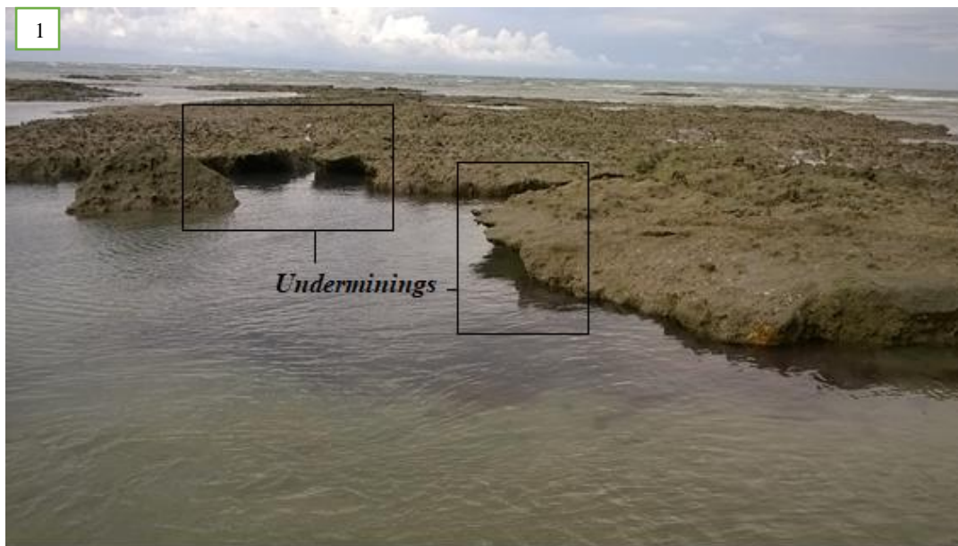
Figura 14 – Plataforma de abrasão no faixa de praia da margem direita (1) com presença de underminings ; (2) e fraturamentos.
