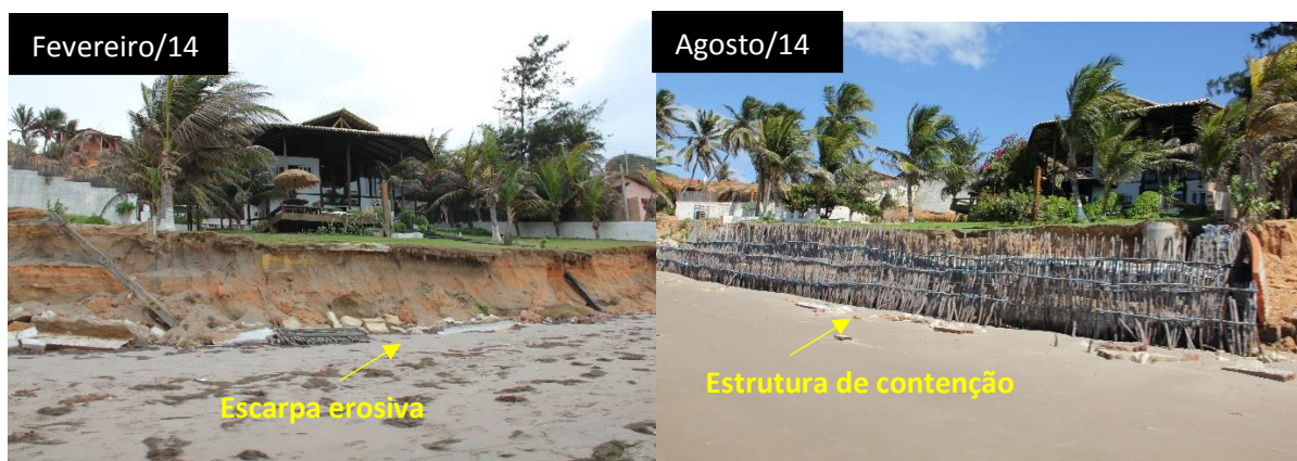
Figura 55: Evolução da atuação dos processos erosivos nas estruturas construídas ao longo da linha de costa na proximidade do ponto 1.
