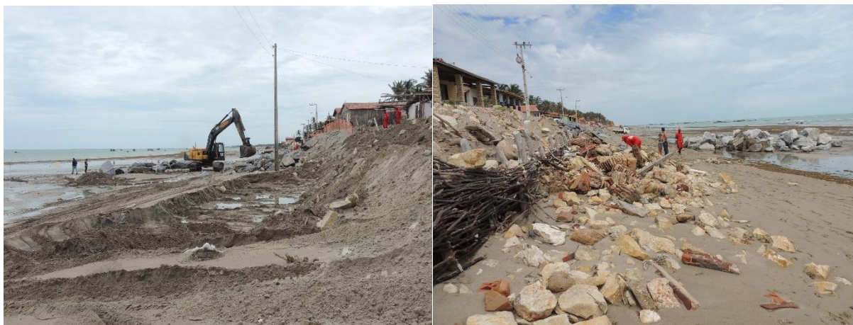
Figura 59: Fotos tiradas em fevereiro de 2016 durante a construção do enrocamento na área do Ponto 2.
