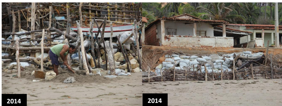
Figura 51: Métodos de contenção da erosão costeira na Praia de Barreiras de Baixo.
