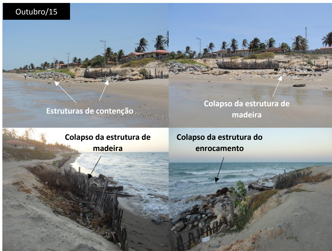
Figura 66: Colapso na estrutura do enrocamento à sotamar do marco fixo do ponto de monitoramento 4.
