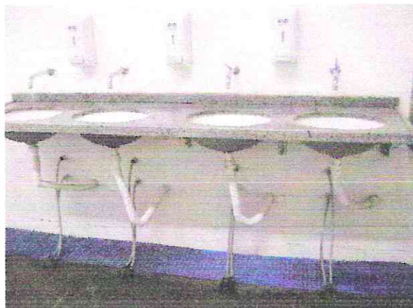
Figura 21- Bancada de lavatórios no gabinete de higienização para lavagem das mãos e antebraços dos funcionários antes da entrada dos mesmos no salão de beneficiamento, na Indústria INTERFRIOS – Intercâmbio de Frios S.A., em Fortaleza, Ceará.
